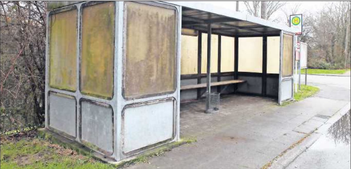
Diese Bushaltestelle soll umgestaltet werden.
